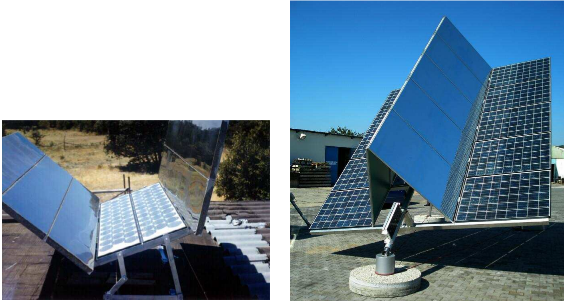
Figura 1.3: Sistemas fotovoltaicos con espejos para concentrar la radiación solar.
